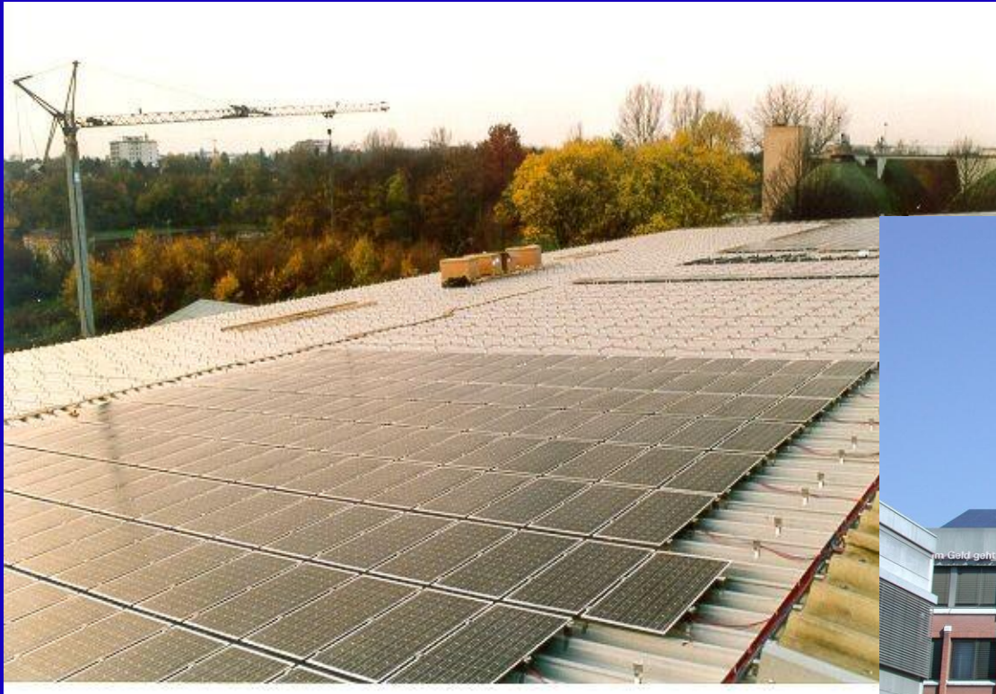
Oben: PV-Anlage auf dem Heidelberger Kompostwerk - mit 300 kW die damals größte in der Region
