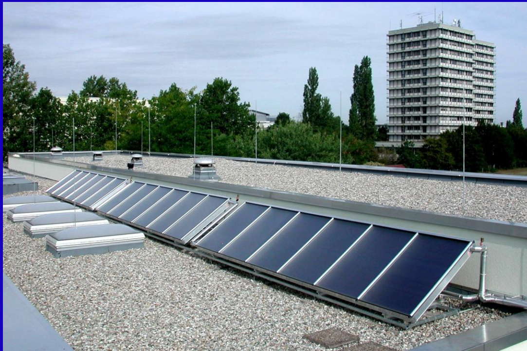
Oben: Solaranlage Marie-Baum-Schule
