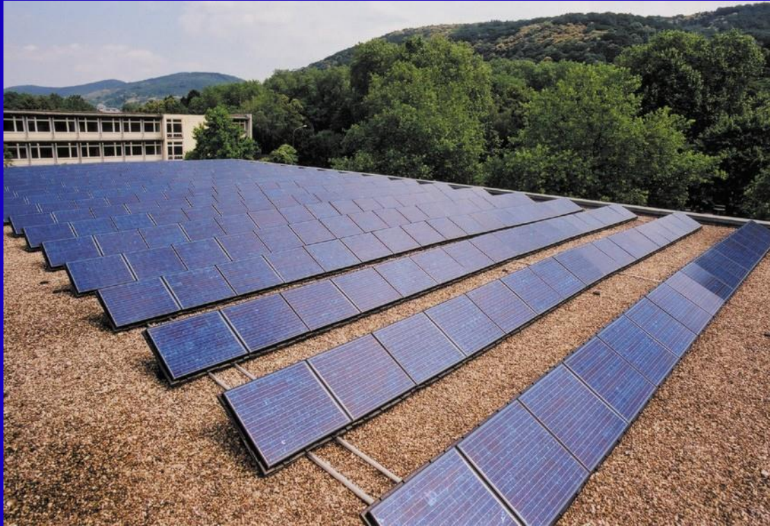
PV-Anlage auf dem Helmholtz-Gymnasium
